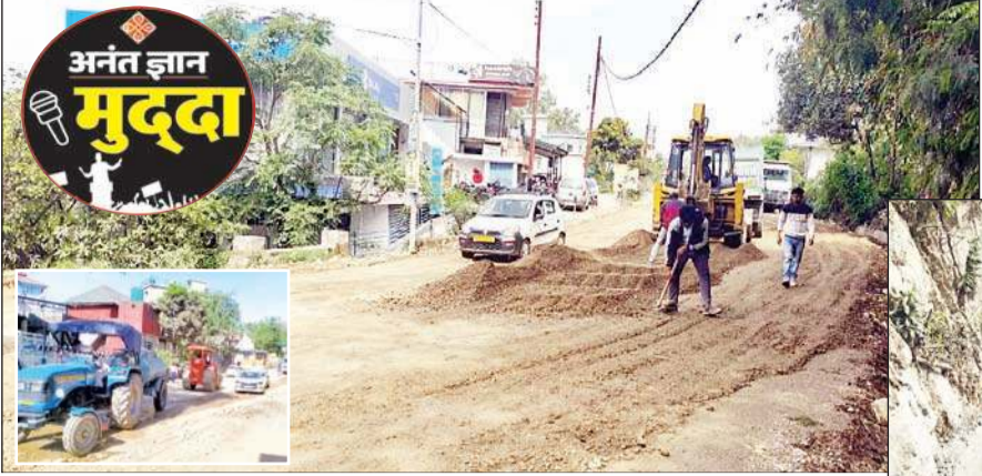
सड़क के निर्माण में लगे मजदूर और नालियां बनाने का काम जारी है।
