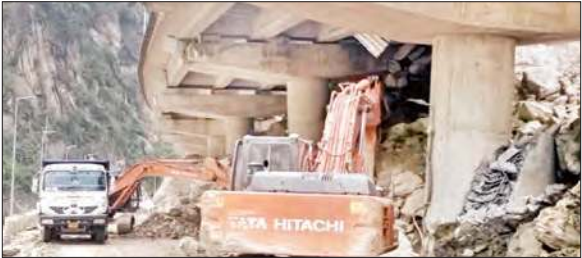
कीरतपुर–मनाली फोरलेन के दवाड़ा फ्लाईओवर के नीचे का पिल्लर क्षतिग्रस्त।
