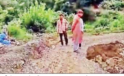
पानी के बहाव से क्षतिग्रस्त कुन्नु-साहल-गजौन सड़क।
