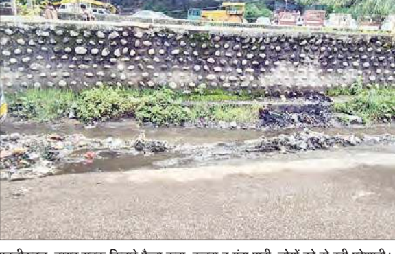
पतलीकूहल-नगर सड़क किनारे फैला कूड़ा-कचरा व गंद पानी, लोगों को हो रही परेशानी।
