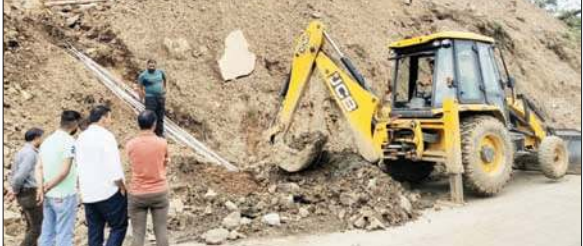
बीते सात वर्षों से राजगढ़ में पार्किंग का निर्माण कार्य अधर में लटका पड़ा, पार्किंग का शिलान्यास और अग्रा पड़ा निर्माण कार्य।
