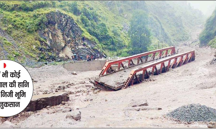
चंबा जिले के चुराह की पंचायत बघेईगढ़ के कटवाड़ में बादल फटने से आई बाढ़ के मलबे में धंसा क्षतिग्रस्त स्टील ब्रिज।
