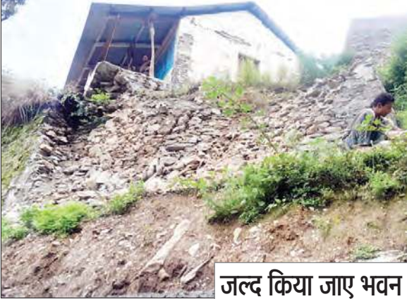
जर्जर हालत में भवन, जहां बच्चे पढ़ने को मजबूर हैं।
