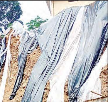
एनएन निर्माण कंपनी की कटिंग के बाद सुरक्षा दीवार न लगाने से घरों को उत्पन्न हुआ खतरा।
