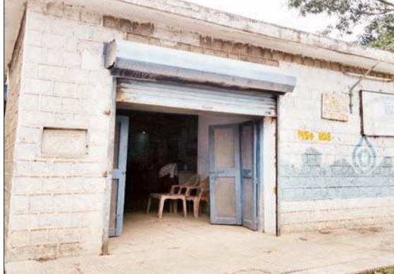
दुग्ध अभीशीतन केंद्र जलाड़ी का भवन जो जर्जर अवस्था में खड़ा है।
