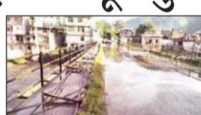
लिफ्ट बहाने बनाती रही है। हद तो तब हो गई जब गत एक माह पूर्व इसी सड़क मार्ग के मेन पुल को रेलिंग टूट गई और रेलिंग पुल के पैदल फुटपाथ पर बिखरी पड़ी है।
