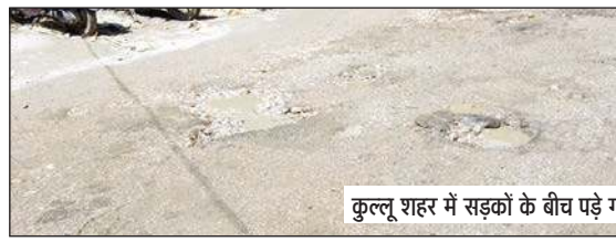
कुल्लू शहर में सड़कों के बीच पड़े गड़ढे।
