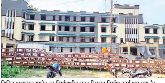
सिविल अस्पताल गगरेट का निर्माणधीन भवन जिसका निर्माण कार्य थम गया है।
