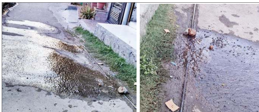
बिलासपुर शहर के कोसरियां वार्ड में जगह-जगह पर टूटी हैं पाइपें, जिससे लोगों को हो रही पानी की किल्लत।
